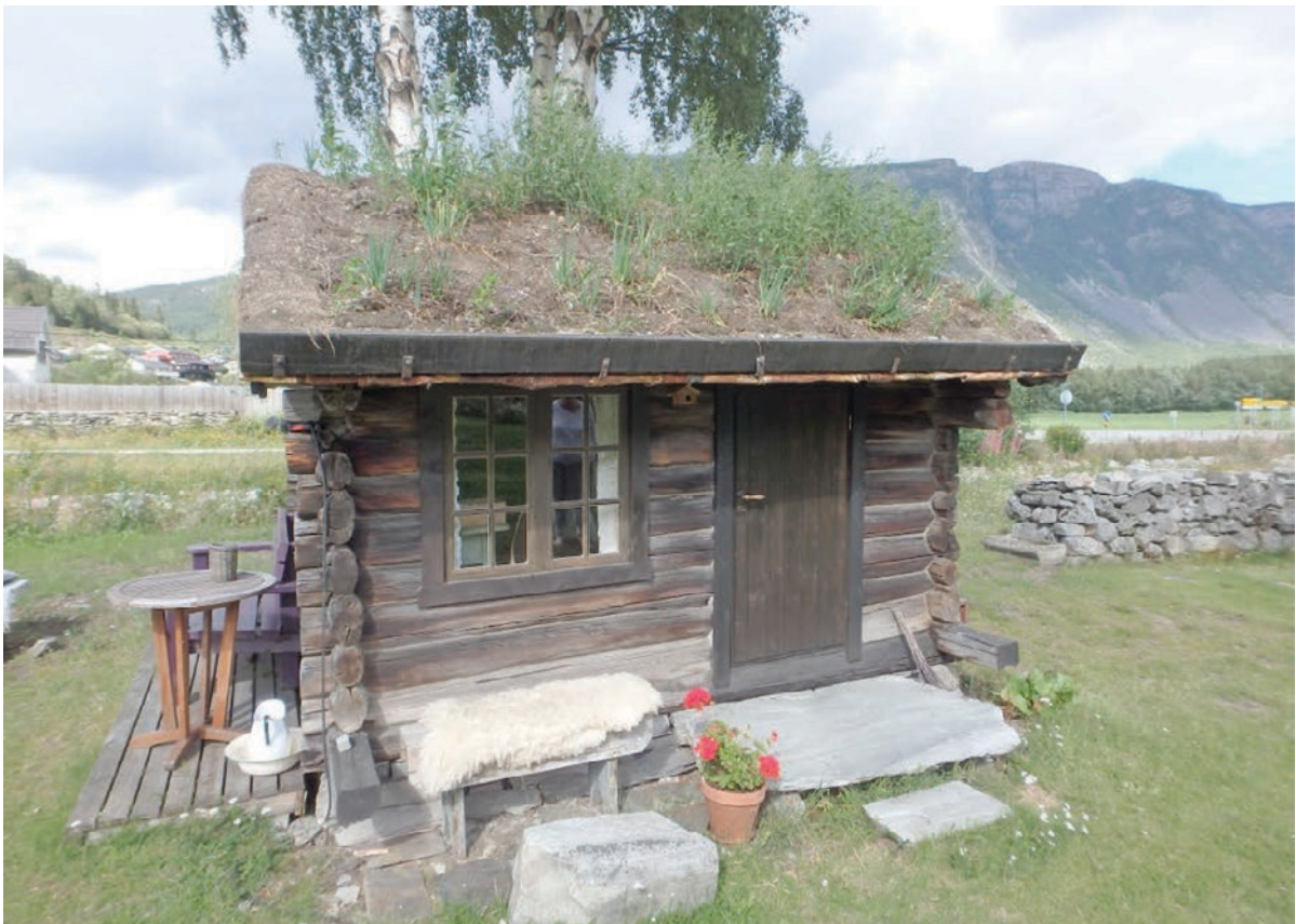
Figur 54. Eldhuset var nylig restaurert, og pipeløk stod spredt med frisk og frodig på det glisne torvtaket. Foto: Bjørn Harald Larsen.
