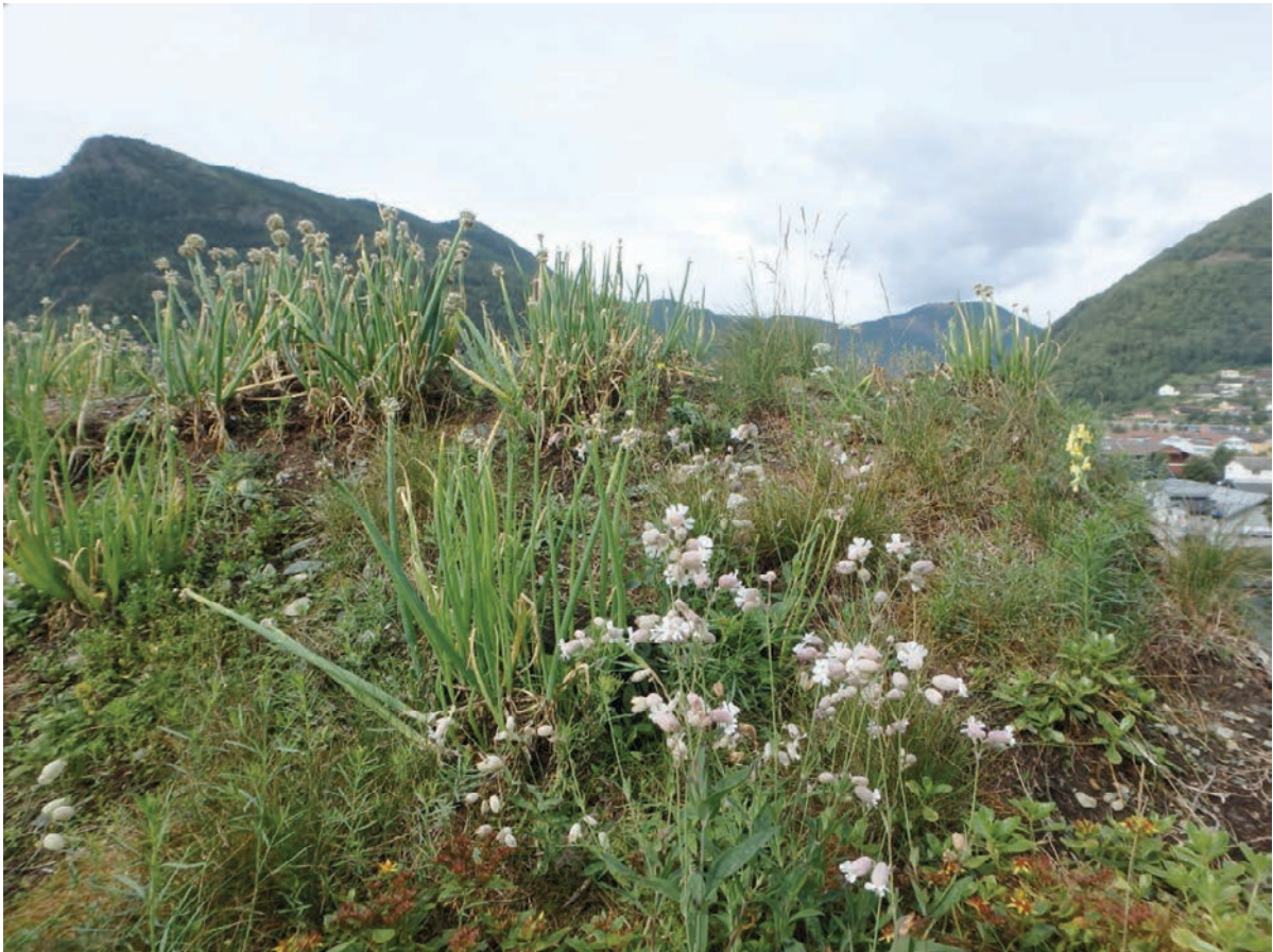
Figur 70. Pipeløk på hyttetak i Kongsvegen 6 i Otta. Denne løken kommer fra Skreddarstugu rett nord for Otta sentrum, der den stod på et stabbur helt ut mot E6. Dette ble solgt og tatt ned i 1993, mens altså noen av pipeløkene ble plantet på dette hyttetaket. Foto: Bjørn Harald Larsen.
