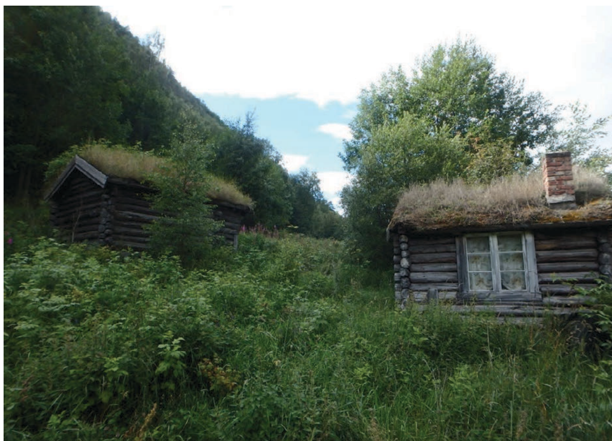
Figur 47. Bygningene på Formofetten var i forfall, og torvtakene var gamle og preget av gjengroing med mose og bringebær. Foto: Bjørn Harald Larsen.
