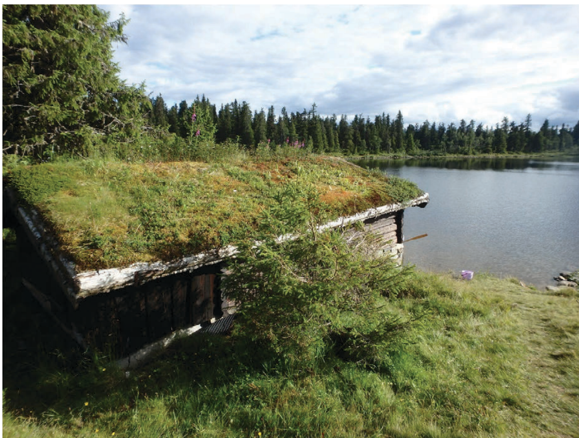
Figur 7. Torvtaket har nå trolig for tett og frisk/fuktig vegetasjon for pipeløk. Foto: Bjørn Harald Larsen, 3.8.2016.
