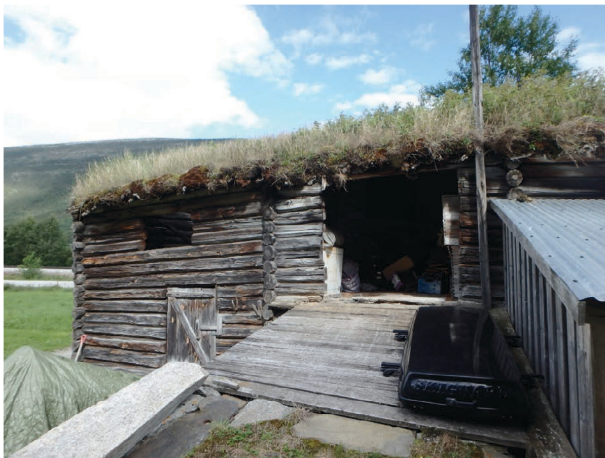
Figur 41. Det ble registrert mest pipeløk på den vestvendte delen av låvetaket. Foto: Bjørn Harald Larsen.
