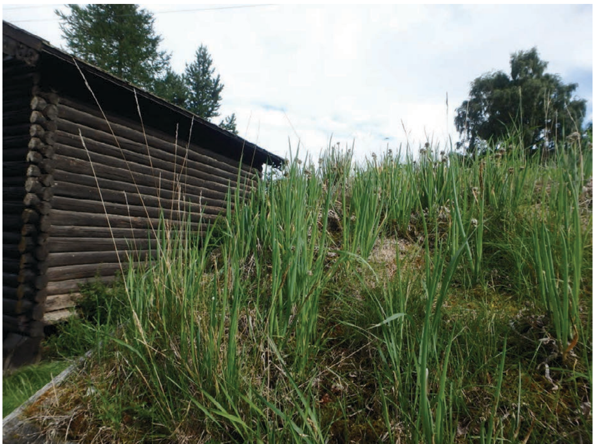
Figur 26. Lekstuetaket har tett bestand av pipeløk på sørsida. Foto: Bjørn Harald Larsen.
